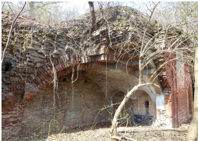
Widok jednego ze zniszczonych przęseł.
