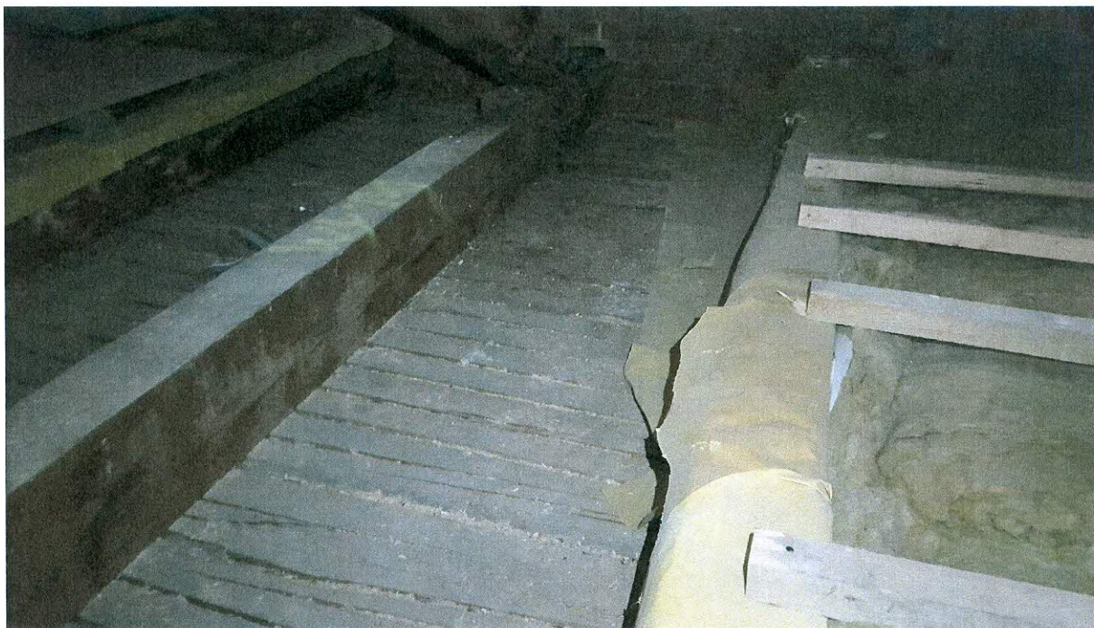
Fot. widoczne zniszczenie uszkodzonej belki na odcinku 1,2 m
