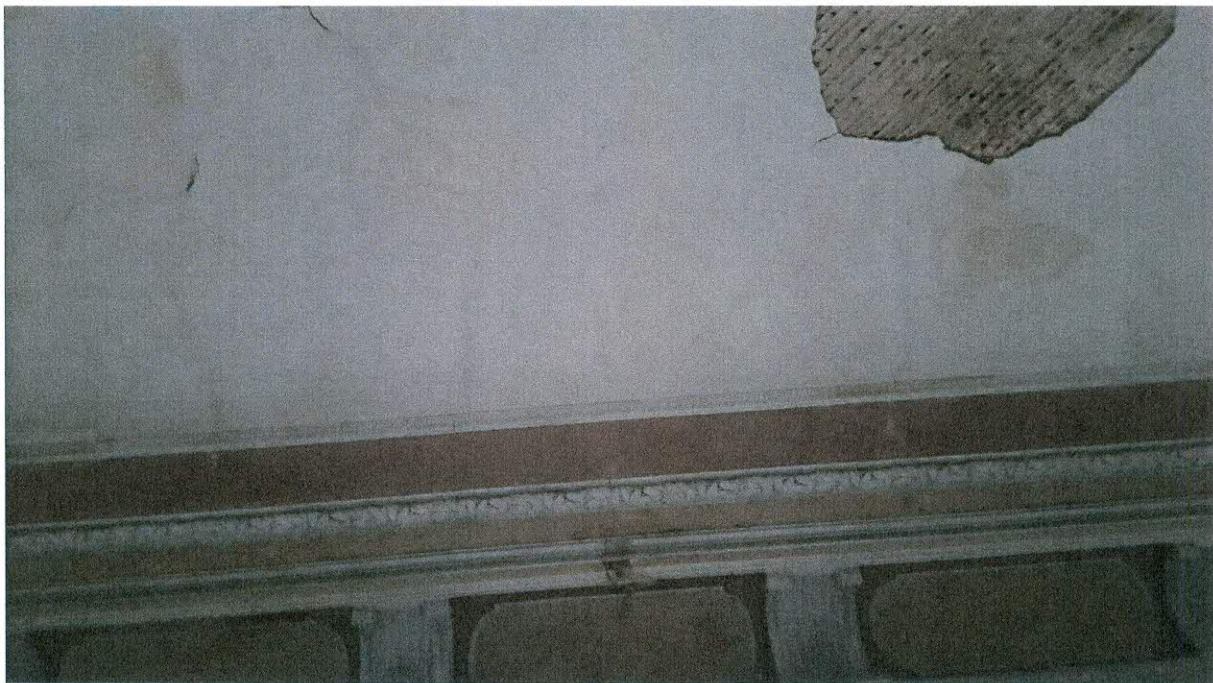
Fot. widoczne spękania tynku w okolicy belki spowodowane przedostawaniem się deszczówki przed naprawą dachu
