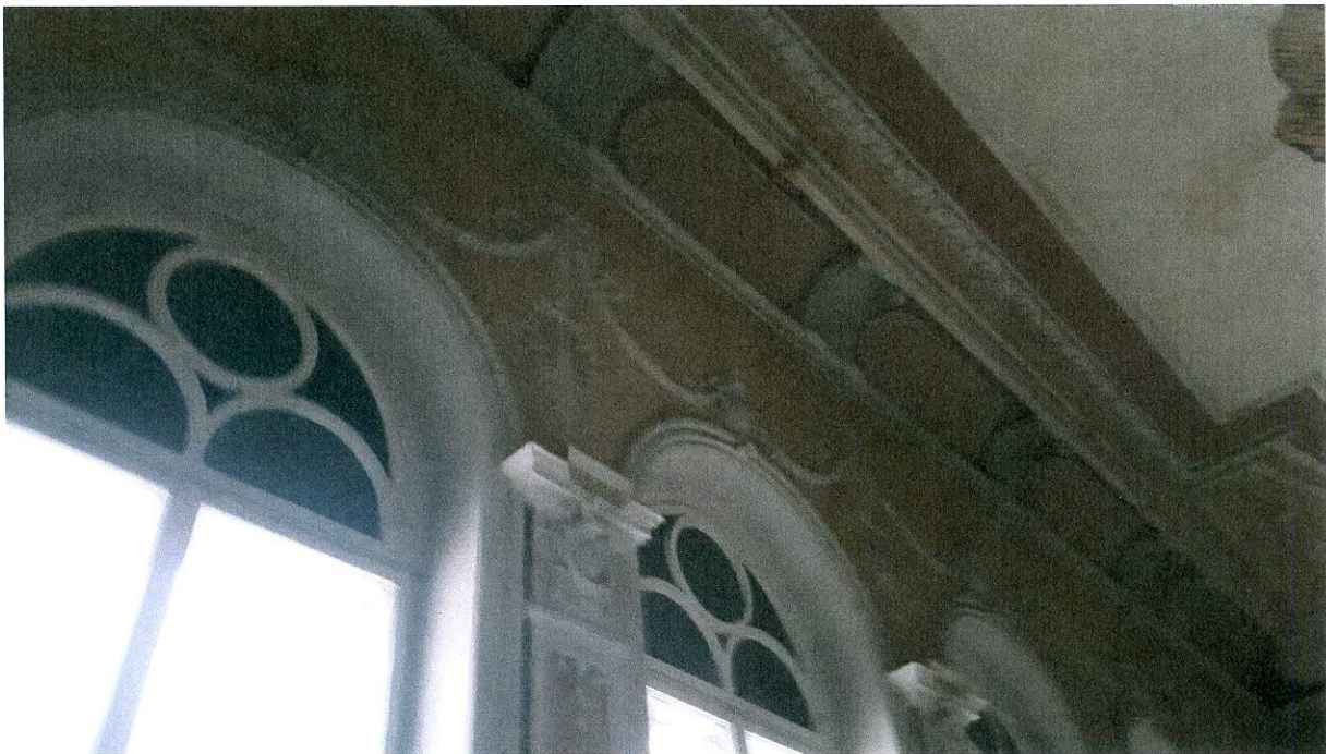
Fot. ułożenia belki wymagającej naprawy – znajduje się nad filarem
