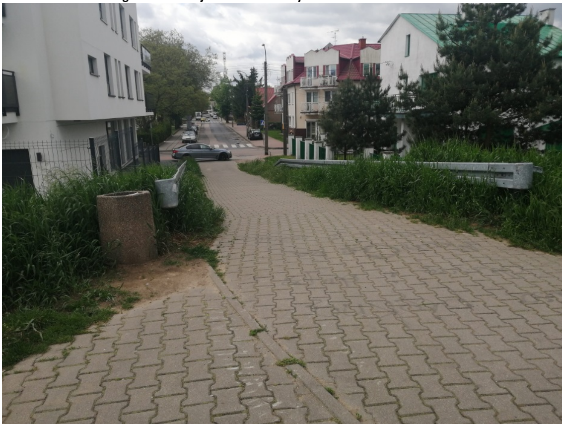
Fotografia 11. Przejazd z kostki na wysokości ul. Kościuszki – zawale
