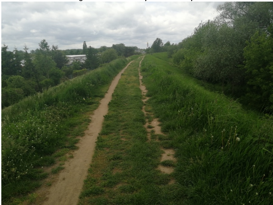
Fotografia 2. Nie umocniony odcinek korony wału.
