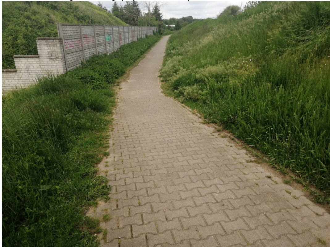
Fotografia 4. Droga przywałowa do oczyszczenia i odchwaszczenia
