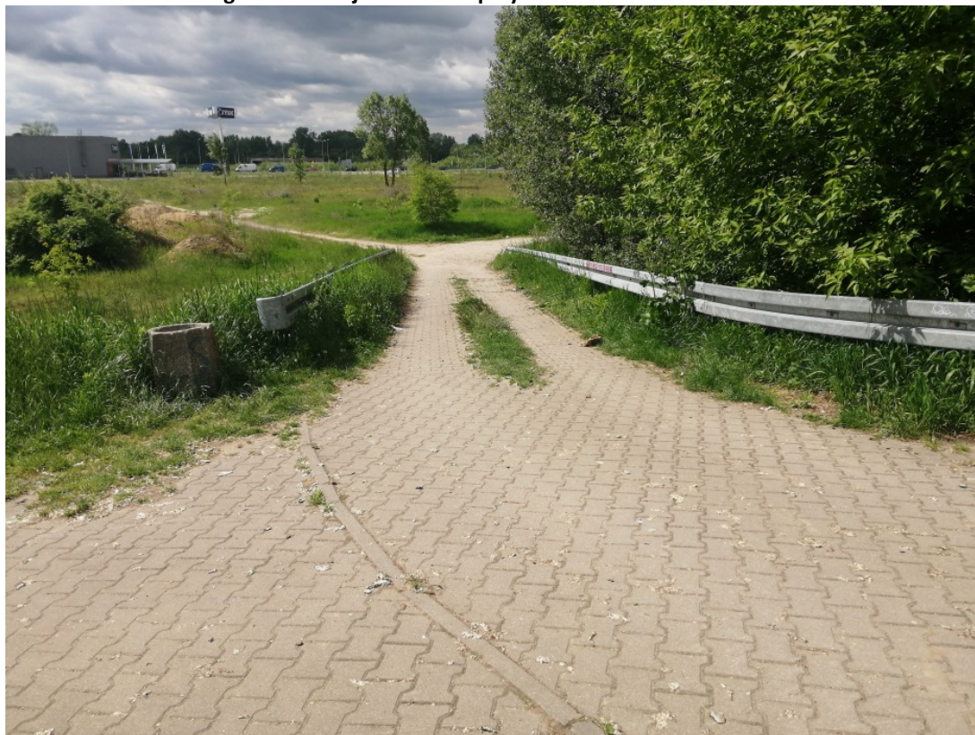
Fotografia 8. Przejazd z kostki przy CH HIT w km 0+300 – zawale
